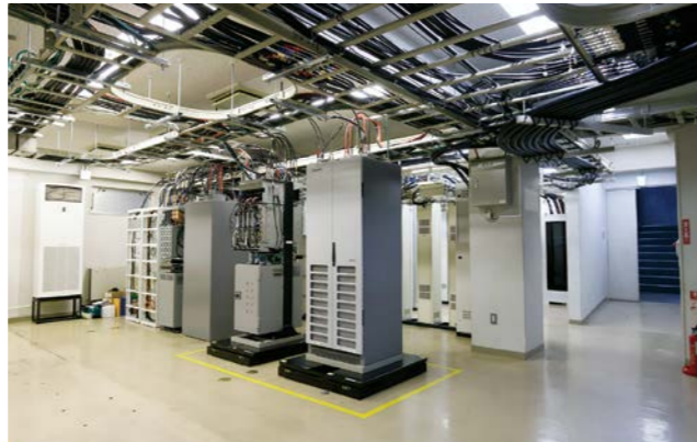
通信基地局設備
