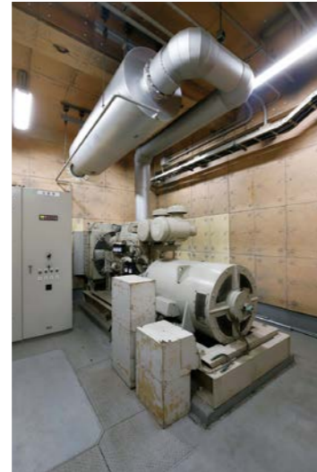
自家発電設備
