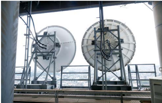
固定通信用パラボラアンテナ設備
